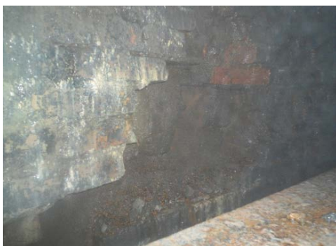
Rys. 1. Ubytki obudowy murowej
