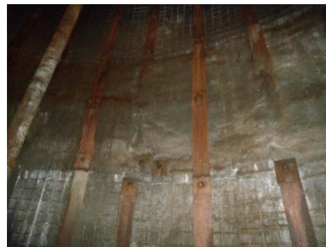
Rys. 6. Kawerna zamurowana i zabezpieczona przykotwioną siatką
